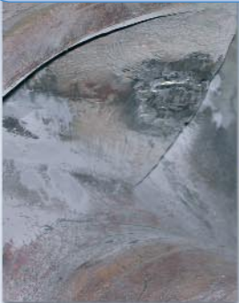
A járókerék és a szivattyúház javítás előtt. Jelentős kopás és kavitáció által okozott sérülések a járókeréken
